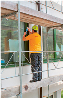
2 Fassadengerüst als Absturzsicherung
